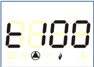
Работа в режиме „Трубочист” с максимальной мощностью
